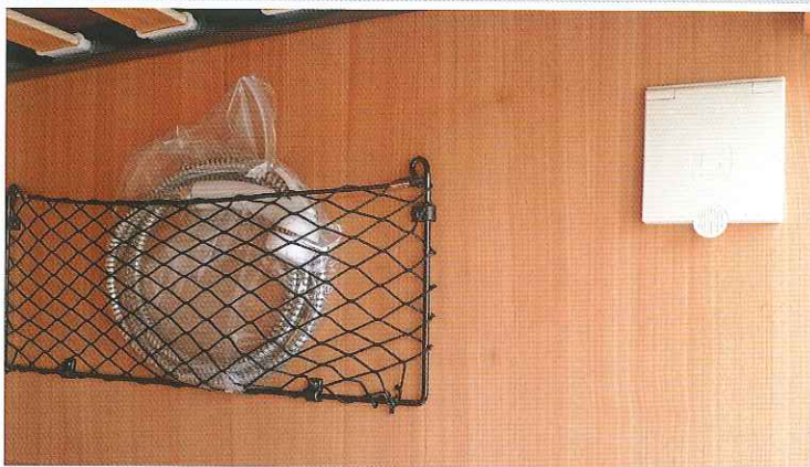
DOUCHETTE EXTERIEURE EAU CHAUDE / FROIDE EXTERNAL SHOWER HOT / COLD WATER
